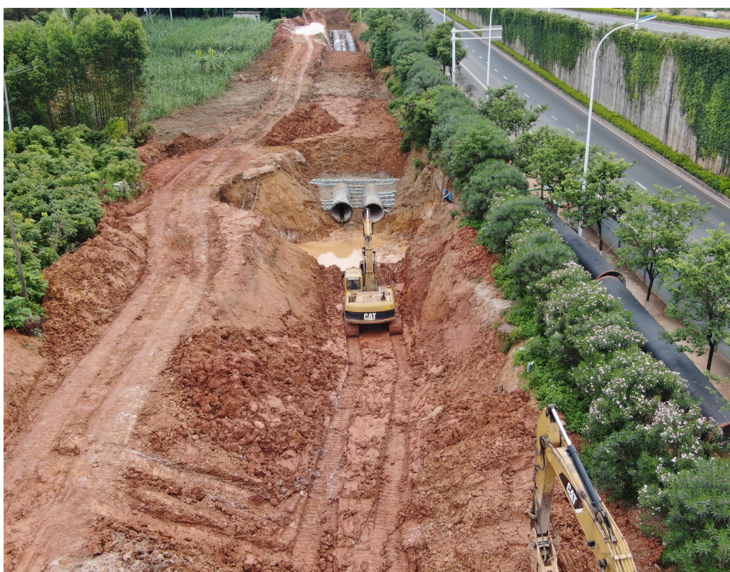
沟槽开挖两侧堆土现状，无拦挡、排水、沉沙、苫盖防护措施
