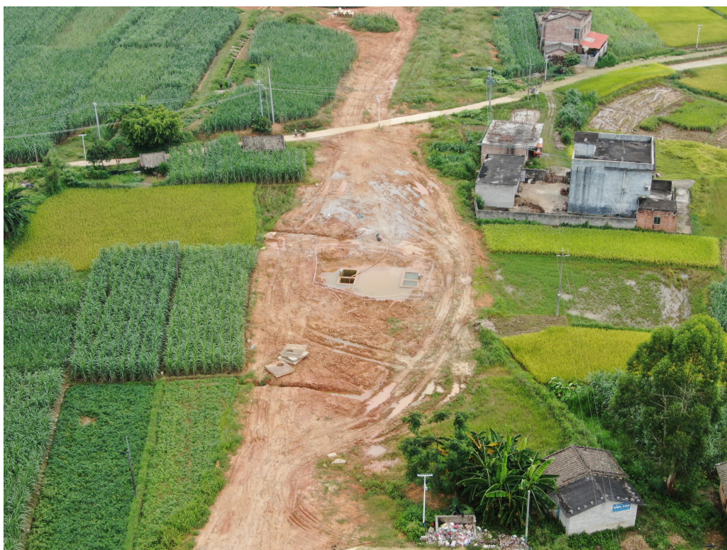
管道敷设沟槽回填后，未布设水土保持防护措施
