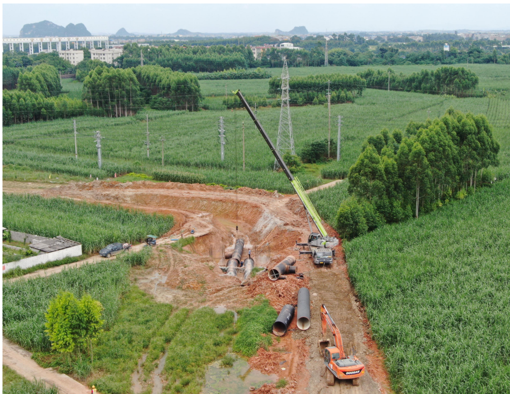
沟槽开挖两侧，无拦挡、排水、沉沙措施
