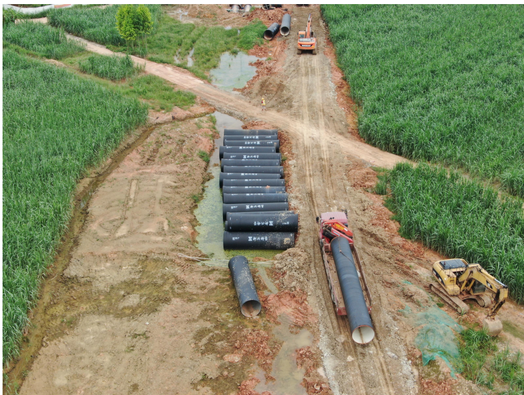
沟槽开挖两侧，无拦挡、排水、沉沙措施
