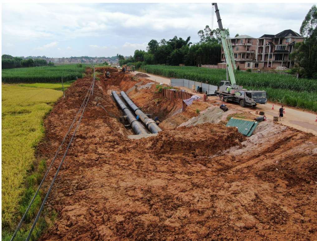
沟槽开挖两侧堆土现状，无拦挡、排水、沉沙、苫盖防护措施
