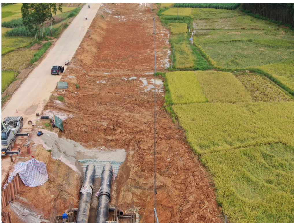
管道敷设沟槽回填后，未布设水土保持防护措施
