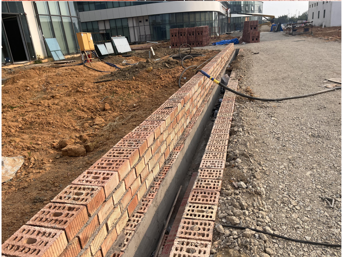
已实施排水沟(2025 年 4 月 10 日拍摄)
