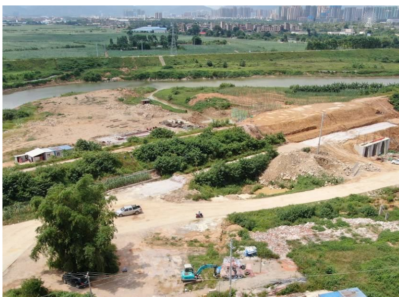
被广西鲤鱼江大冲塘治理工程施工占用区域监测记录图片
